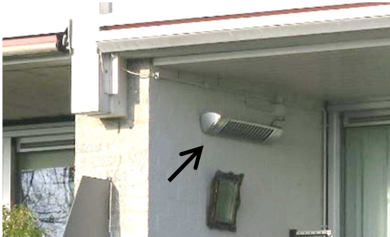
Een elektrisch verwarmingselement is toegestaan.
