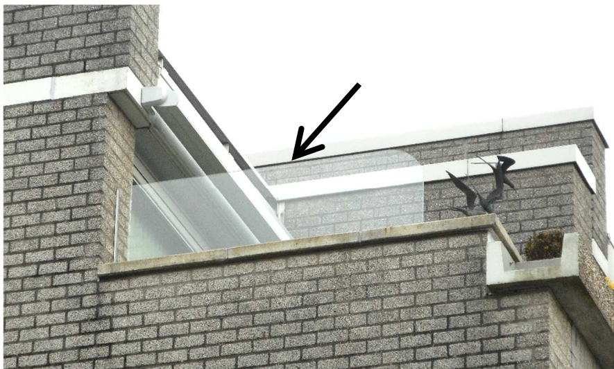
Een windschermconstructie zoals hier afgebeeld is toegestaan in overleg met de Stichting Spaarneborgh.
