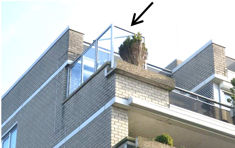
Een windschermconstructie zoals hier afgebeeld is niet toegestaan.
